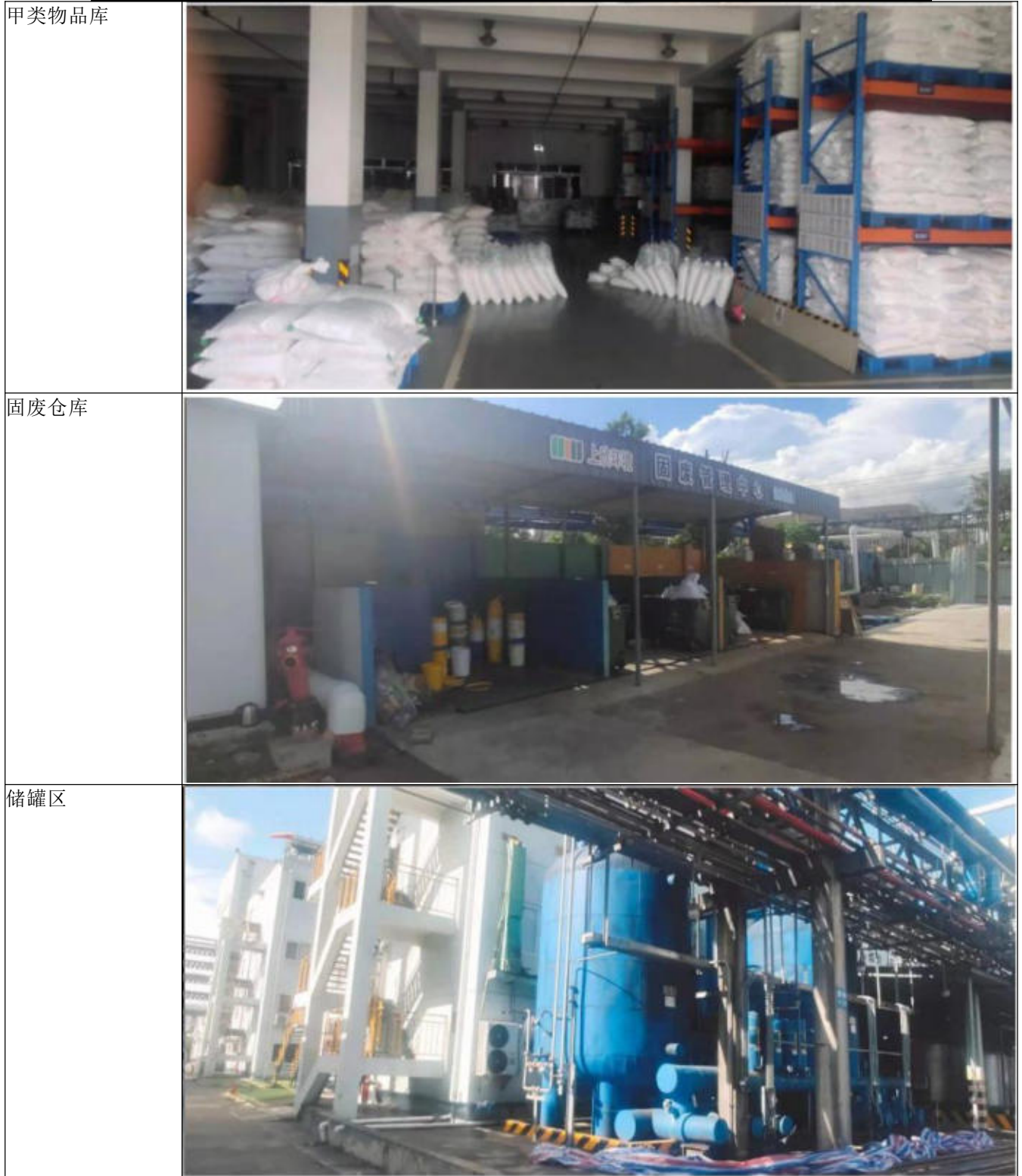
图5.1-1重点场所及重点设施设备现场照片
